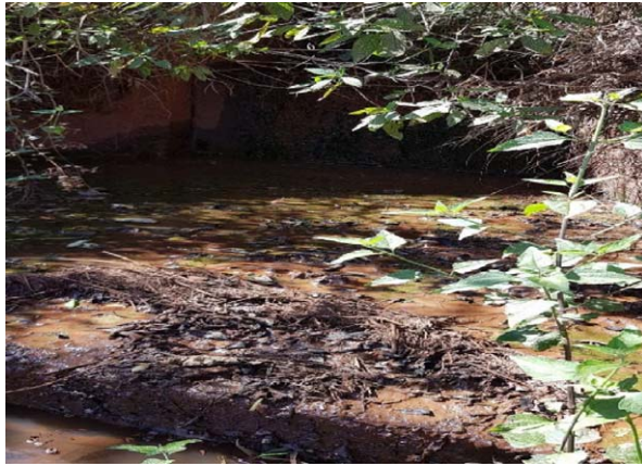
Figura 66: Detalhe da saída do extravasor da B I, assoreada e com erosão abaixo da laje a jusante
