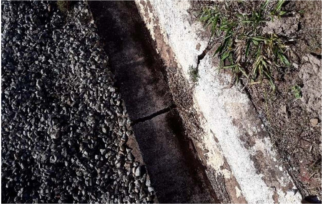
Figura 59: Trinca em canaleta superficial junto à ombreira esquerda da B I
