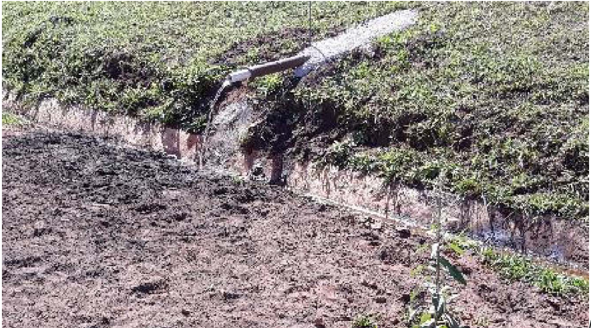
Figura 46: Um dos novos DHP instalados na B I sem a presença de sifão para evitar a entrada de ar
