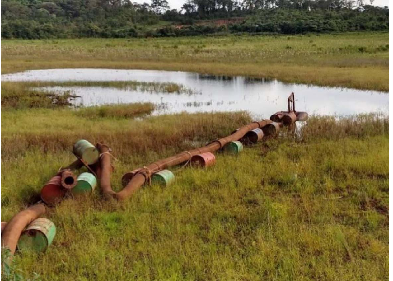
Figura 132: Bomba de água inoperante com formação de lago no reservatório da barragem
