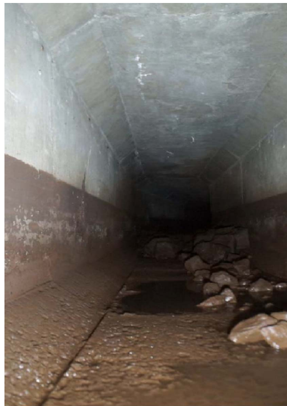
Figura 65: Vista da parte interna da galeria de fundo da B I, com acúmulo de rejeito mineral na parte inferior
