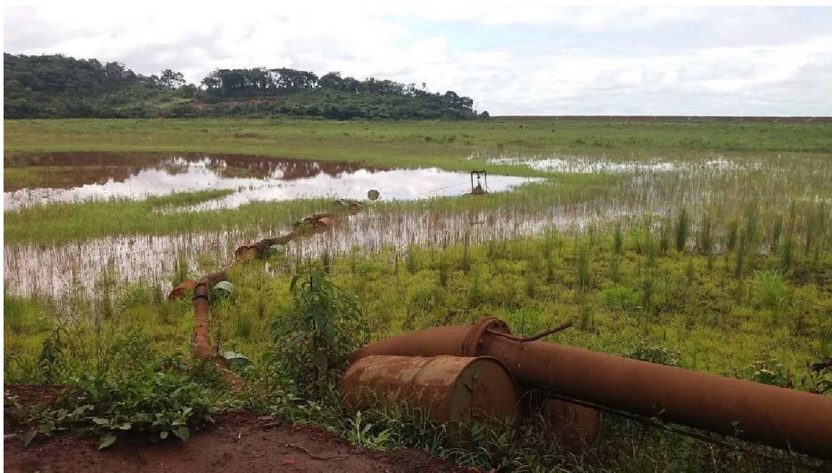
Figura 131: Bomba de água inoperante com formação de lago no reservatório da barragem
