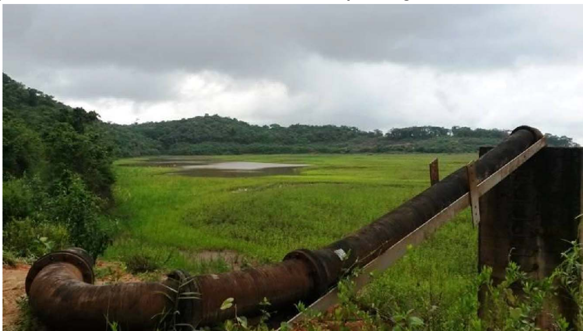
Figura 130: Bombeamento não funcionando com formação de lago no reservatório
