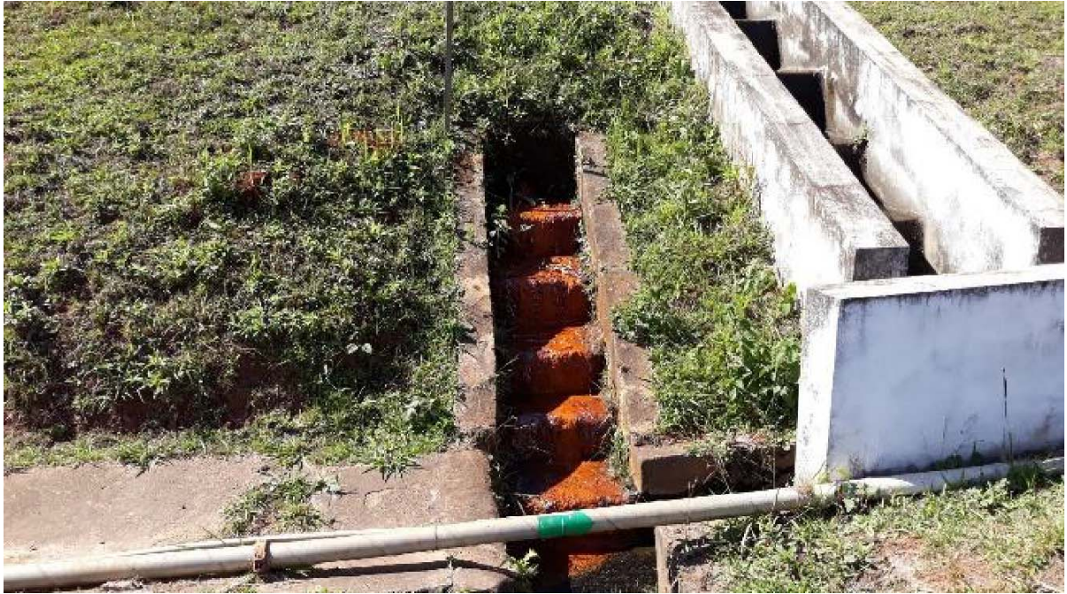
Figura 45: Saída de drenagem interna com colóide na B I
