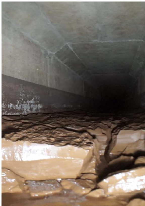
Figura 64: Vista da parte interna da galeria de fundo da B I, com acúmulo de rejeito mineral na parte inferior
