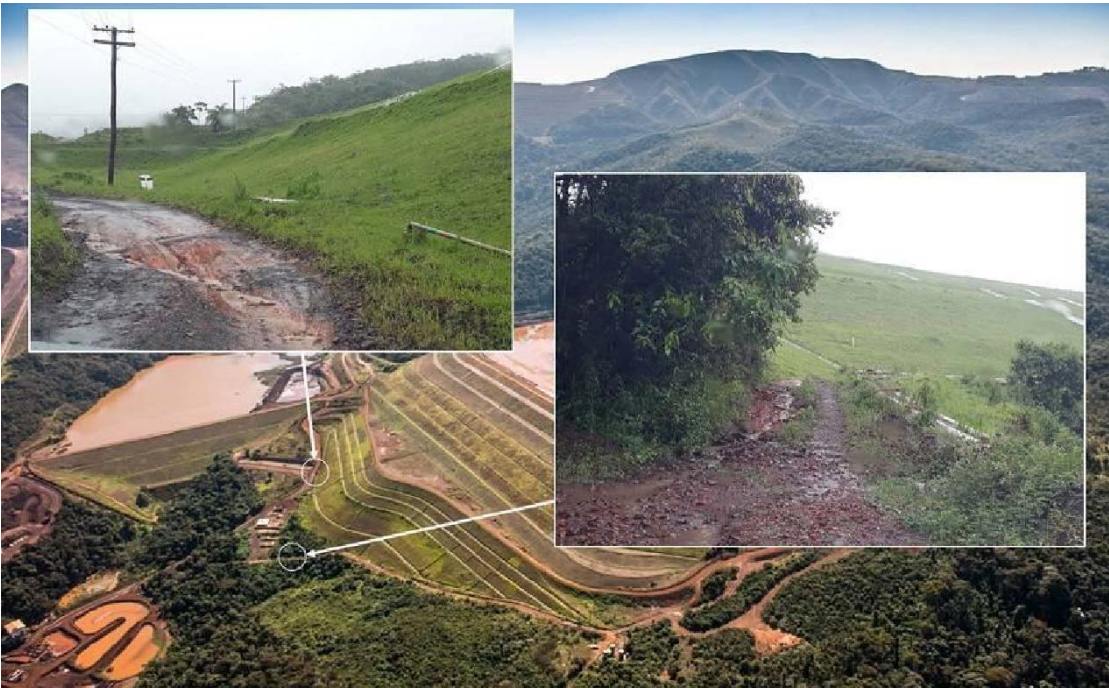
Figura 108: Drenagem superficial inadequada causando acúmulo de água no pé do barramento e formação de erosão
