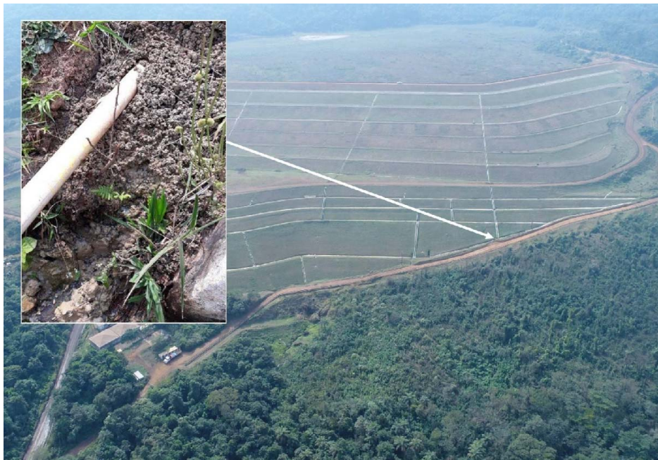
Figura 101: Surgência de água no talude principal próximo à saída de DHP
