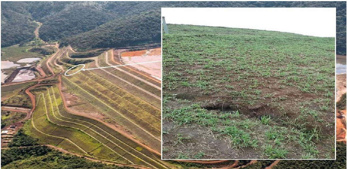
Figura 121: Ravinas na ombreira direita do talude
