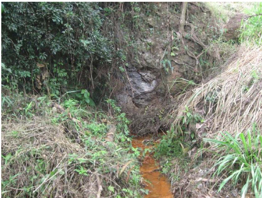
Figura 48: Detalhe de saída de água sob os blocos de canga, pé do dique inicial da B I
