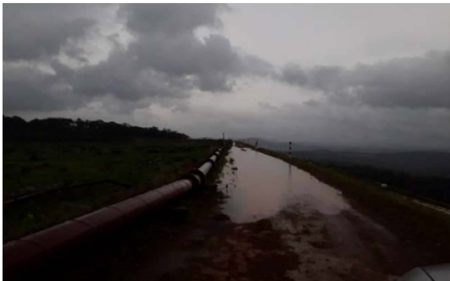
Figura 106: Drenagem superficial da barragem obstruída com acúmulo de água na crista do barramento
