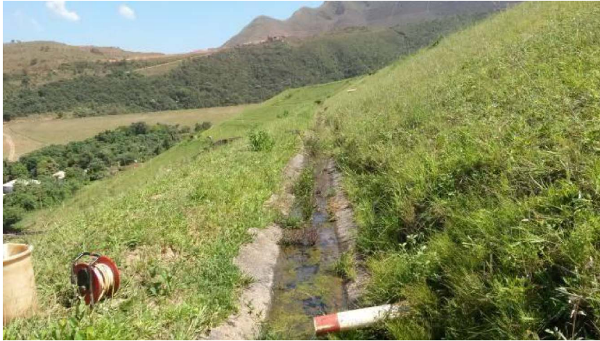
Figura 104: Canaleta de drenagem constantemente assoreada e acumulando água
