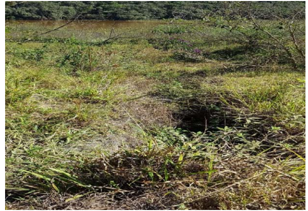
Figura 67: Bacia de dissipação para a Barragem VI totalmente coberta de vegetação
