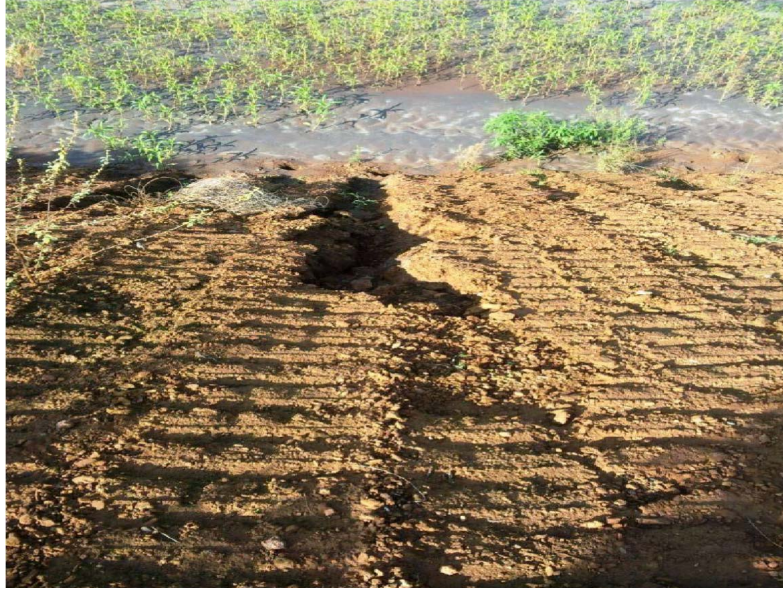
Figura 117: Erosão (ravina) no talude do barramento
