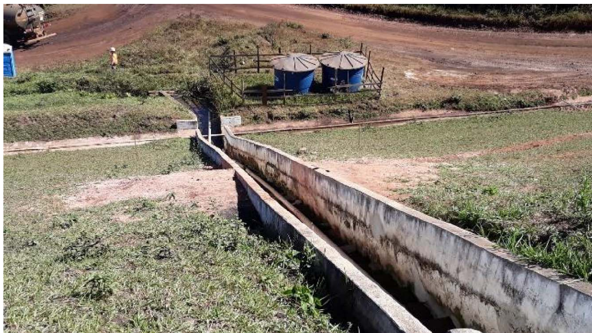
Figura 35: Canaleta em degrau onde ocorreu a surgência de água quando da perfuração de 15º DHP
