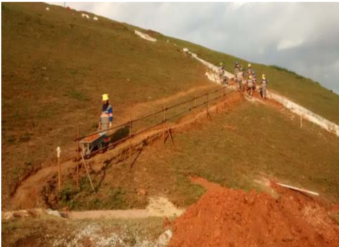
Figura 38: Serviço de retirada de solo escavado do local onde ocorreu a fratura hidráulica
