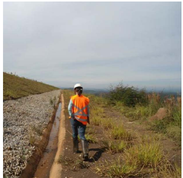
Figura 51: Empoçamento em canaleta de drenagem superficial da B I
