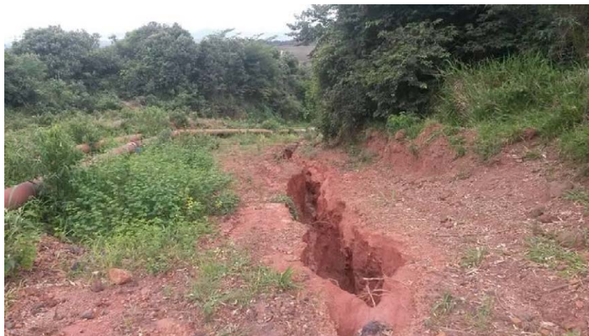
Figura 119: Erosão no acesso à barragem
