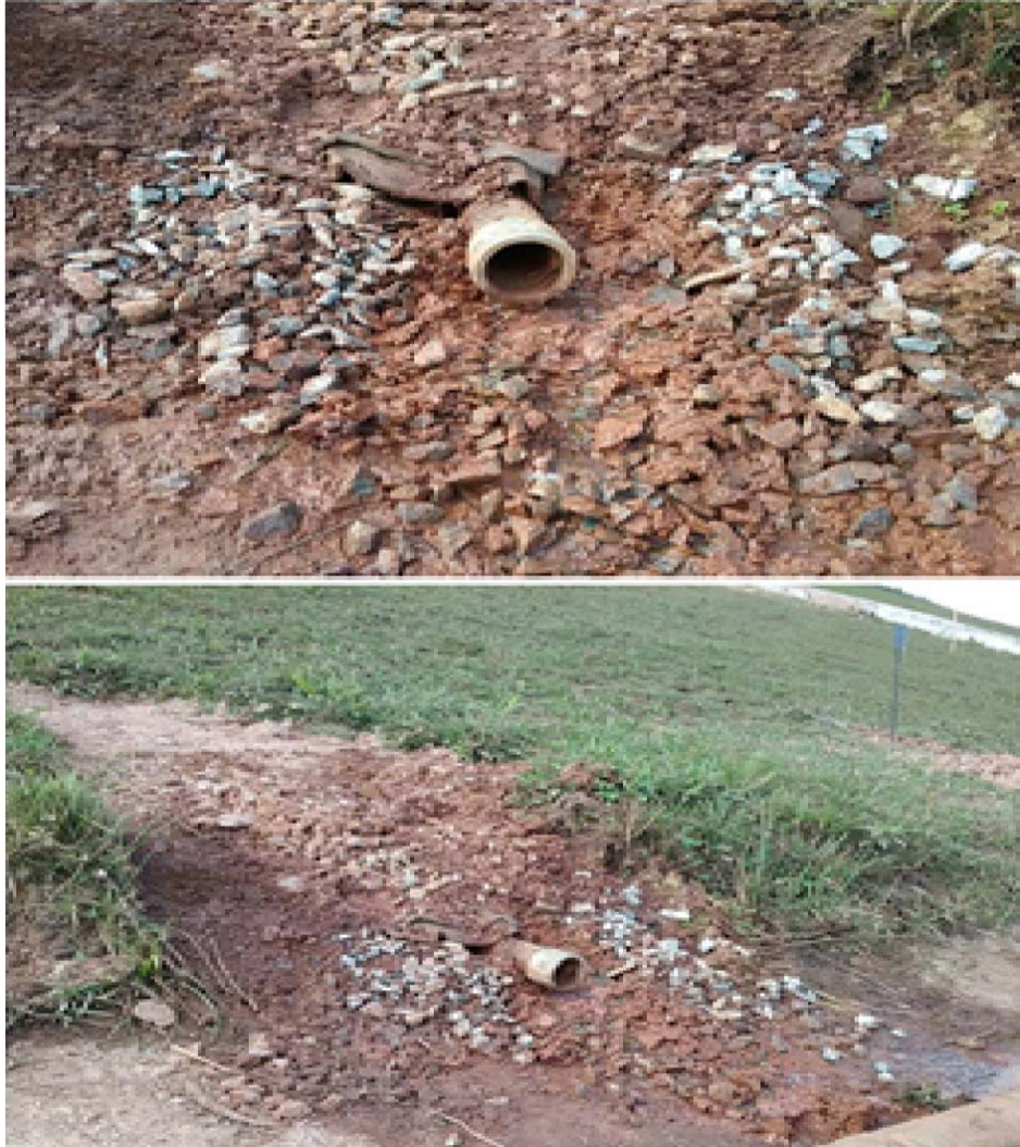
Figura 100: Surgência de água no entorno da saída de Dreno Horizontal Profundo
