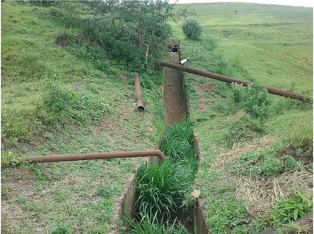
Figura 94: Obstrução de canaleta por vegetação
