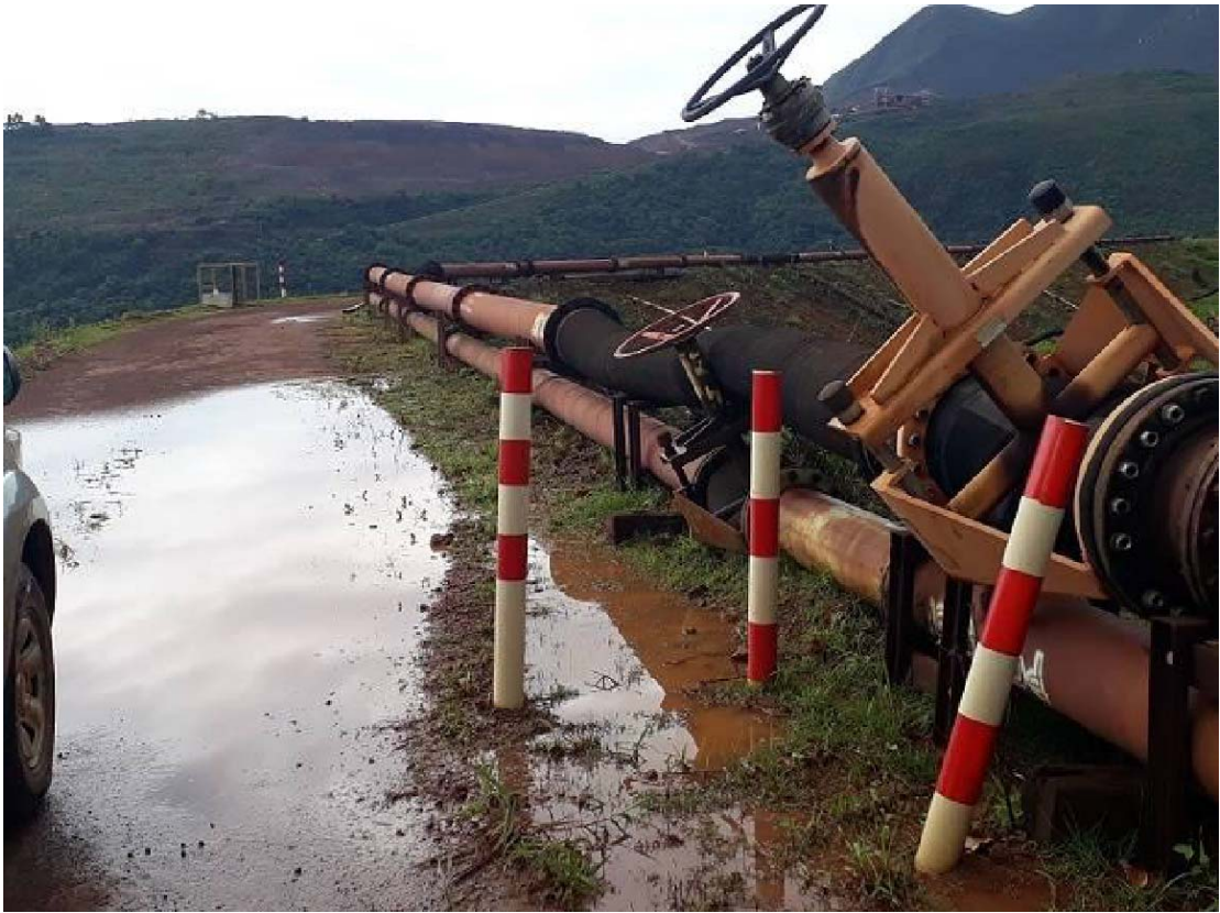
Figura 107: Drenagem superficial da barragem obstruída com acúmulo de água na crista do barramento
