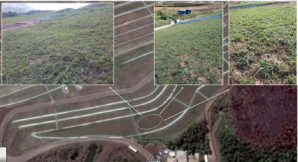
Figura 99: Surgências de água no talude principal
