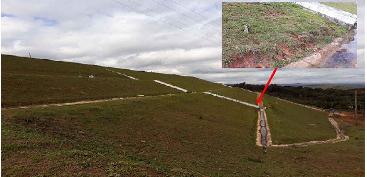
Figura 98: Surgência de água no talude junto à canaleta
