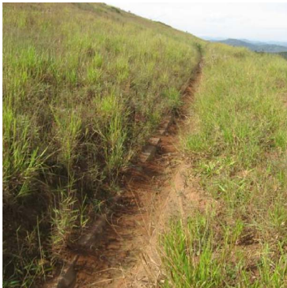
Figura 50: Canaleta de drenagem assoreada em uma das bermas da B I
