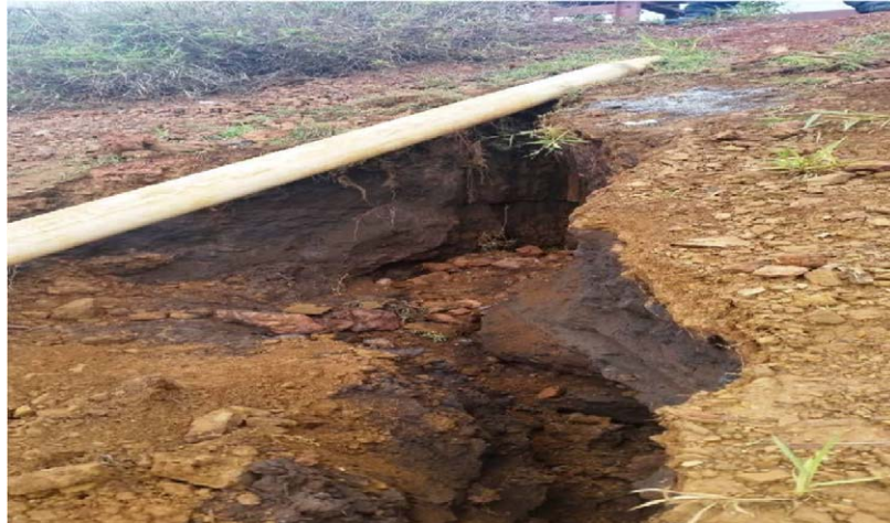
Figura 118: Erosão causada por vazamento de água da tubulação de drenagem que foi danificada por gado
