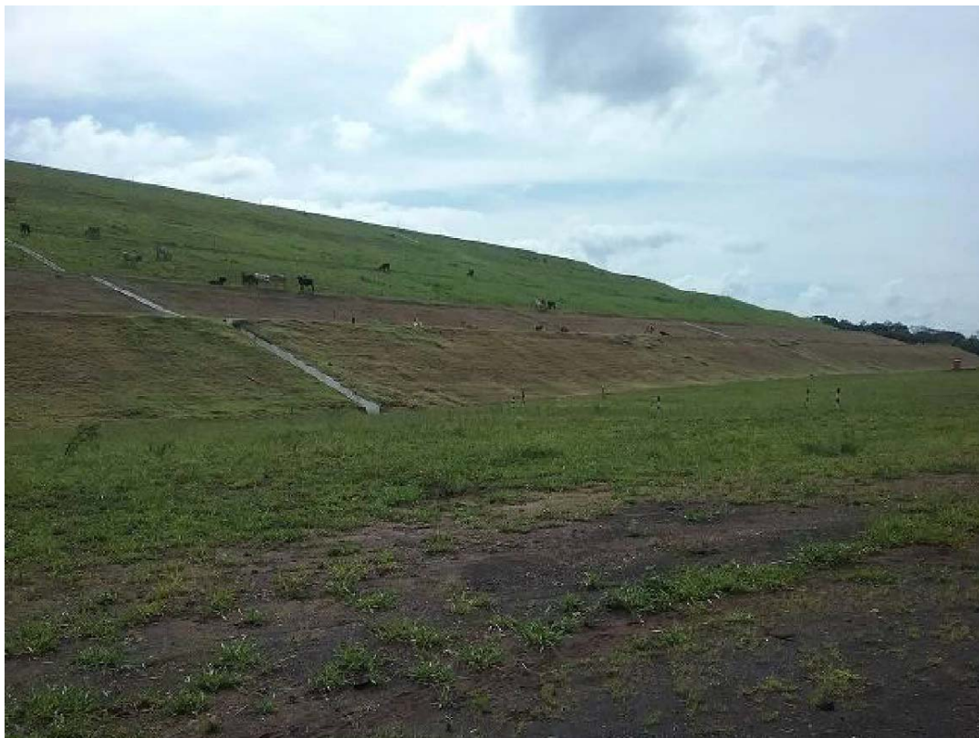
Figura 124: Presença de animais de grande porte no talude do barramento
