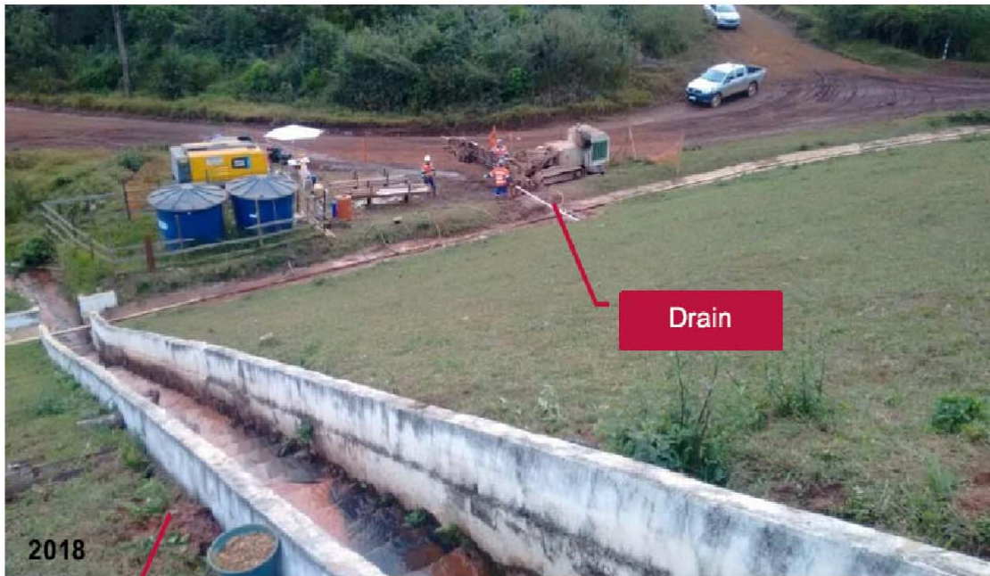
Figura 36: Vista do local de execução do DHP no pé da B I que resultou em fraturamento hidráulico
