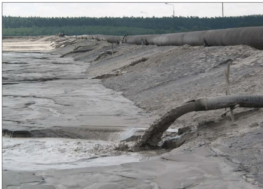
Figura 6 – Deposição de rejeitos de mineração na barragem 14 .
